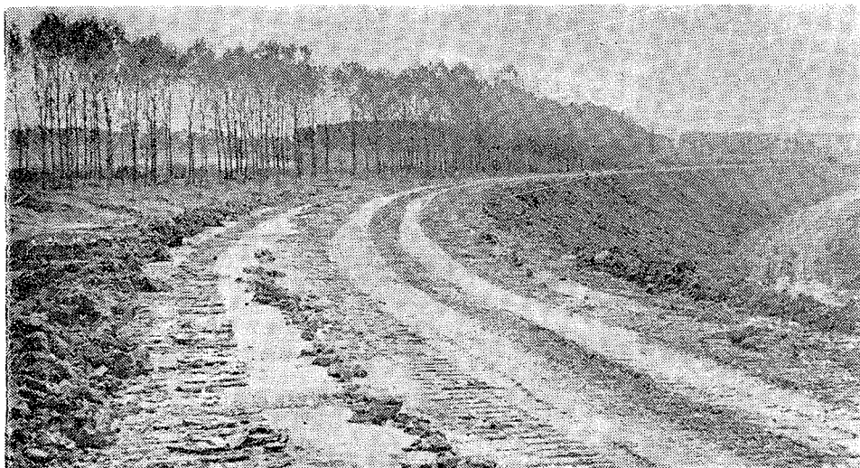
Sl. 22. Nasip na Vijušu kod Slavenskog Broda sagrađen je 1972. godine, ima dužinu 4 km, a brani od velikih voda rijeke Save istočni dio grada Slavenskog Broda
